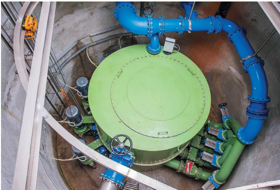
Dolný Kubín – rekonštrukcia čerpacej stanice odpadových vôd – ČS Staré Mesto. Technologické vybavenie. Uzatvorený čerpač systém STRATE
