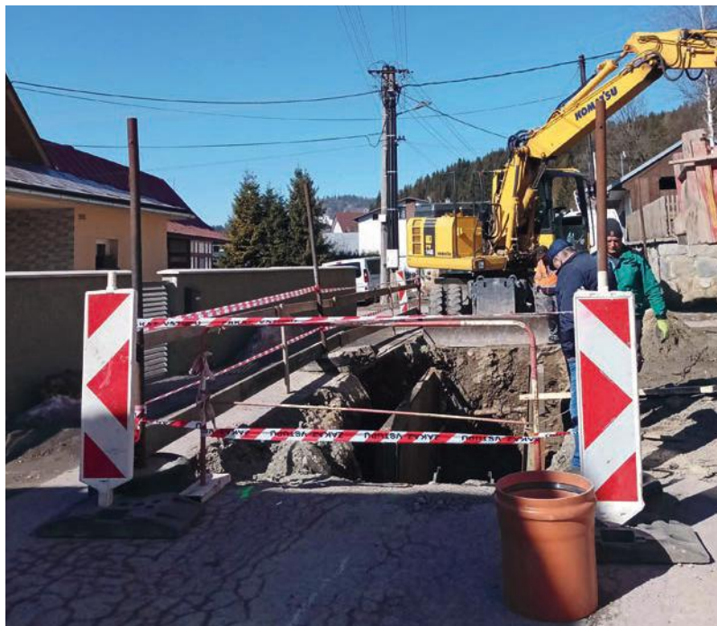
Výstavba kanalizácie v miestnej ceste v rámci projektu spolufinancovaného z európskych fondov IROP „Budovanie verejnej kanalizácie v obci Breza“;
